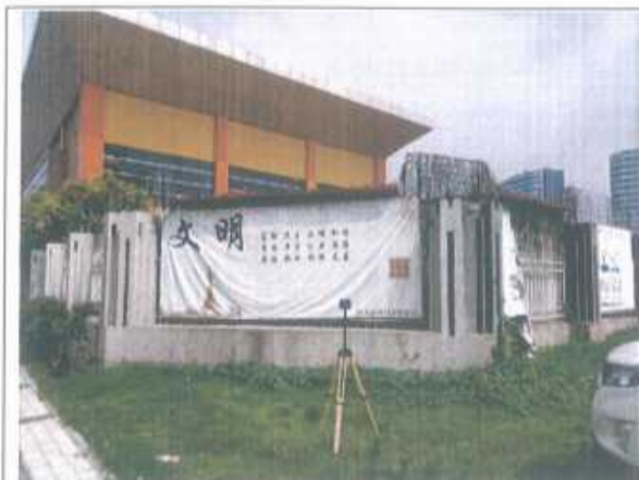
吴元蝶湖 110kV 双回电缆线路（经开第十五大街 沁祥路交叉口）检测照片
