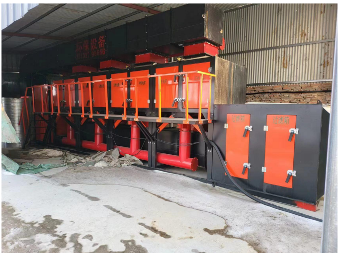
有机废气过滤棉箱+RCO 处理设施
