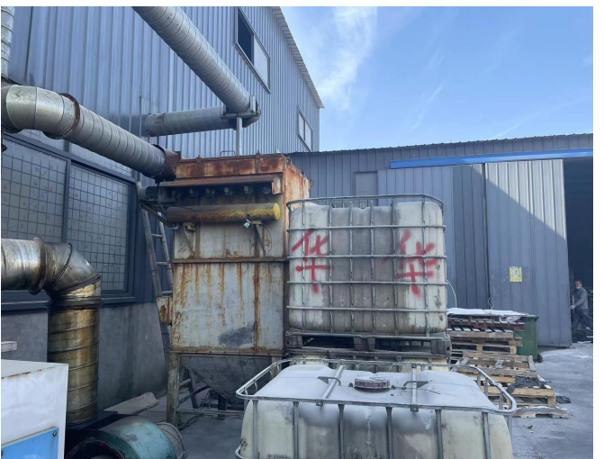
投料粉尘袋式除尘器
